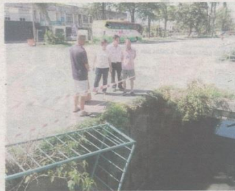
Siok Hwa bersama beberapa wakil penduduk melihat keadaan penghadang jalan yang rosak dan tidak selamat.
